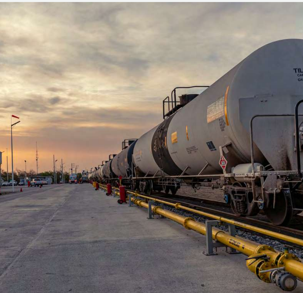
Estación de Combustibles, Cadereyta, México.
