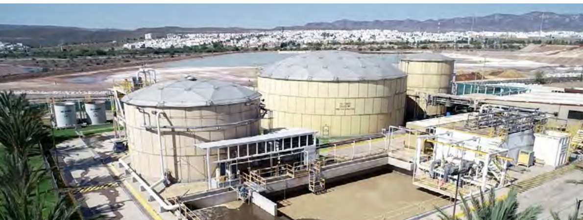
Planta de Tratamiento de Aguas Residuales, Unidad Refinería de Zinc, México.
